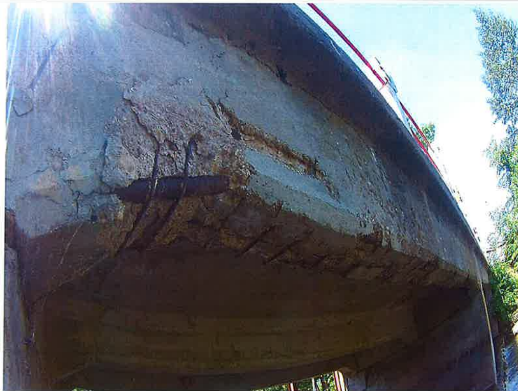
Fot. 1. Znaczne ubytki betonu w jednym z dźwigarów
