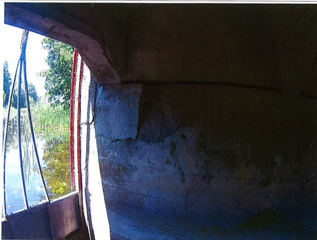
Fot. 3. Ubytek betonu w jednym z filarów
