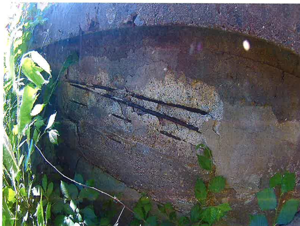
Fot. 4. Ubytek otuliny zbrojeniowej w konstrukcji ściany przyczółka
