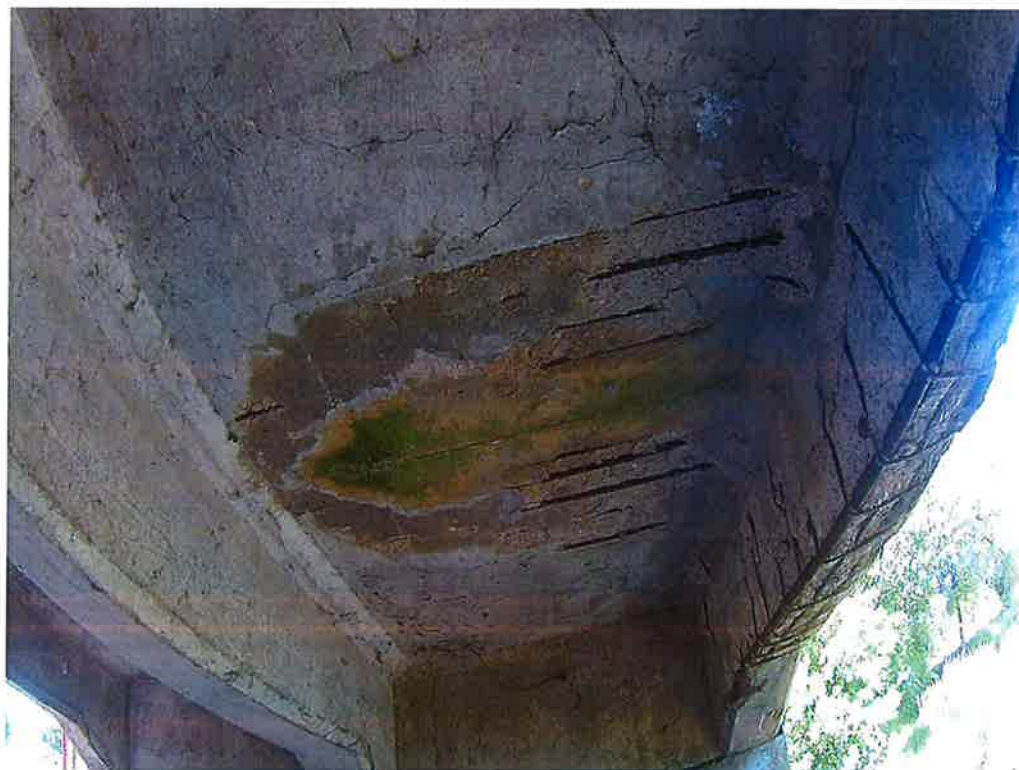
Fot. 2. Ubytki betonu oraz zwilgocenie płyty górnej- wadliwa izolacja
