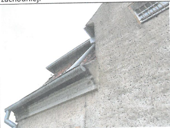
Widoczny fragment uszkodzonego gzymsu.
