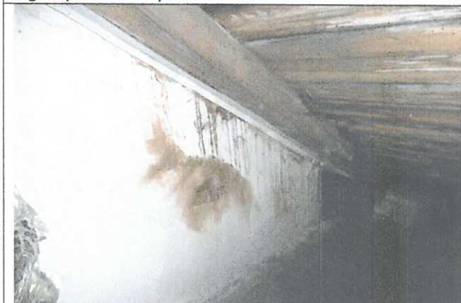
Widoczne spróchniałe deskowanie, zacieki.
