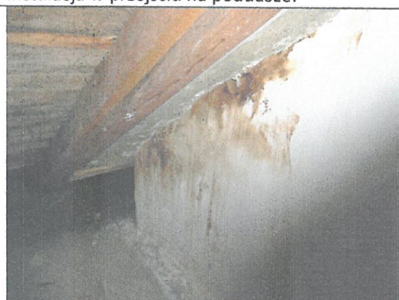
Zacieki przy kominie.
