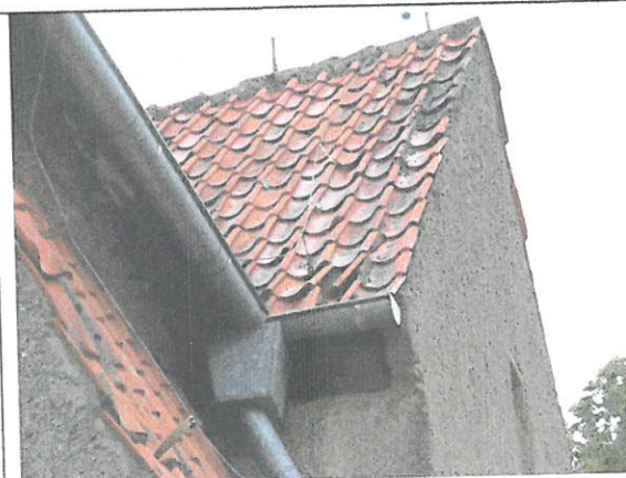
Widoczne luźne przesunięte dachówki.
