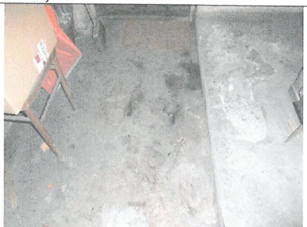
Widok na zniszczoną posadzkę w kotłowni.
