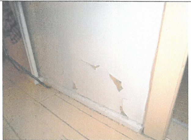
Zniszczona podłoga, odpadające powłoki od ścian.
