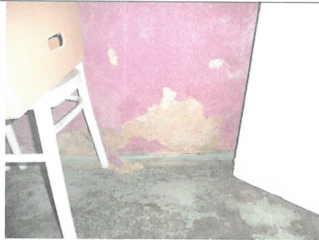
Widoczny fragment zawilgoconej ściany, zmurszały i odpadający tynk.
