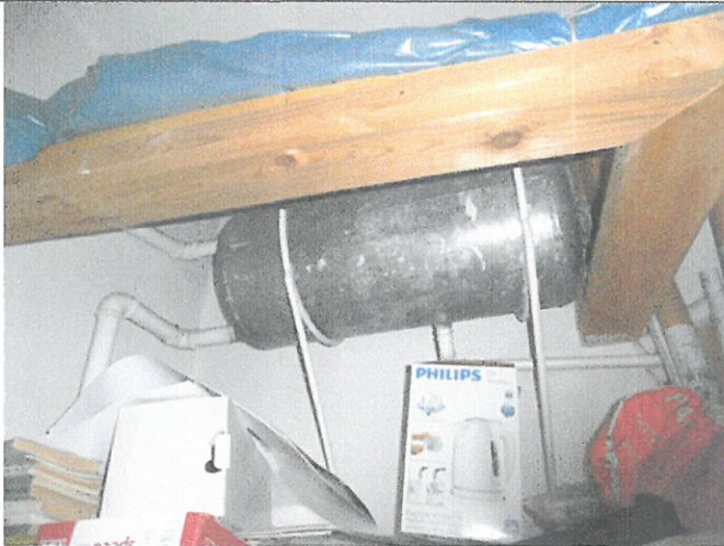
Widok na okap i bojler w pomieszczeniu na piętrze
