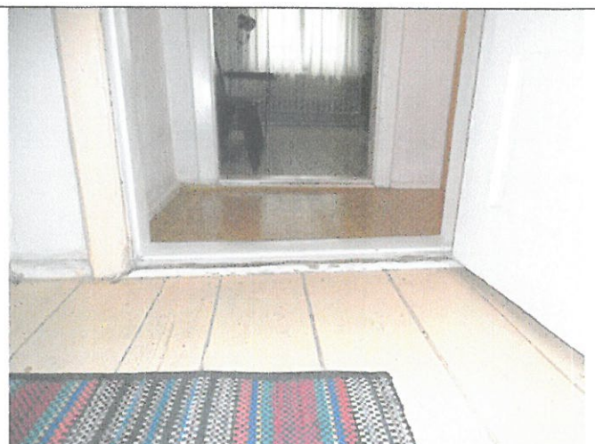
Widoczne wysokie progi między pomieszczeniami na piętrze.
