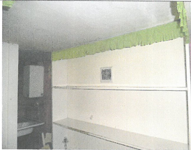
Widoczny fragment pomieszczenia w piwnicy. Na suficie nad zlewem widoczne plamy świadczące o występujących przeciekach w instalacji wodno-kanalizacyjnej.
