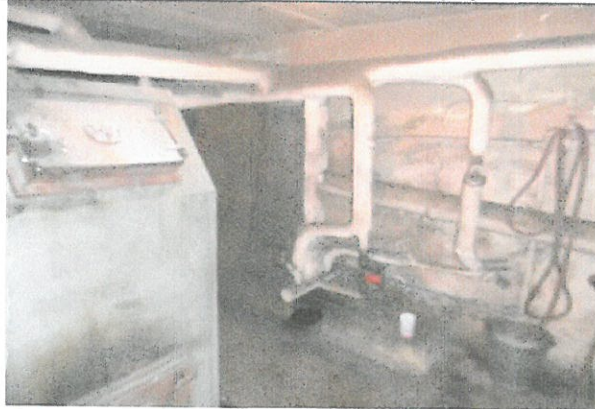
Piec c.o. zamontowany w kotłowni.
