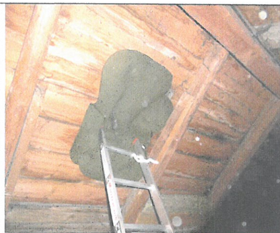
Nieszczelny wyłaz zasłonięty wykładziną.
