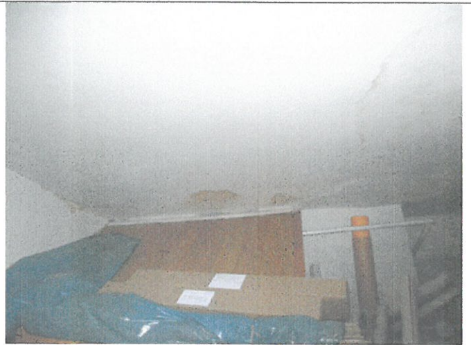
Widoczne ślady po zaciekach.
