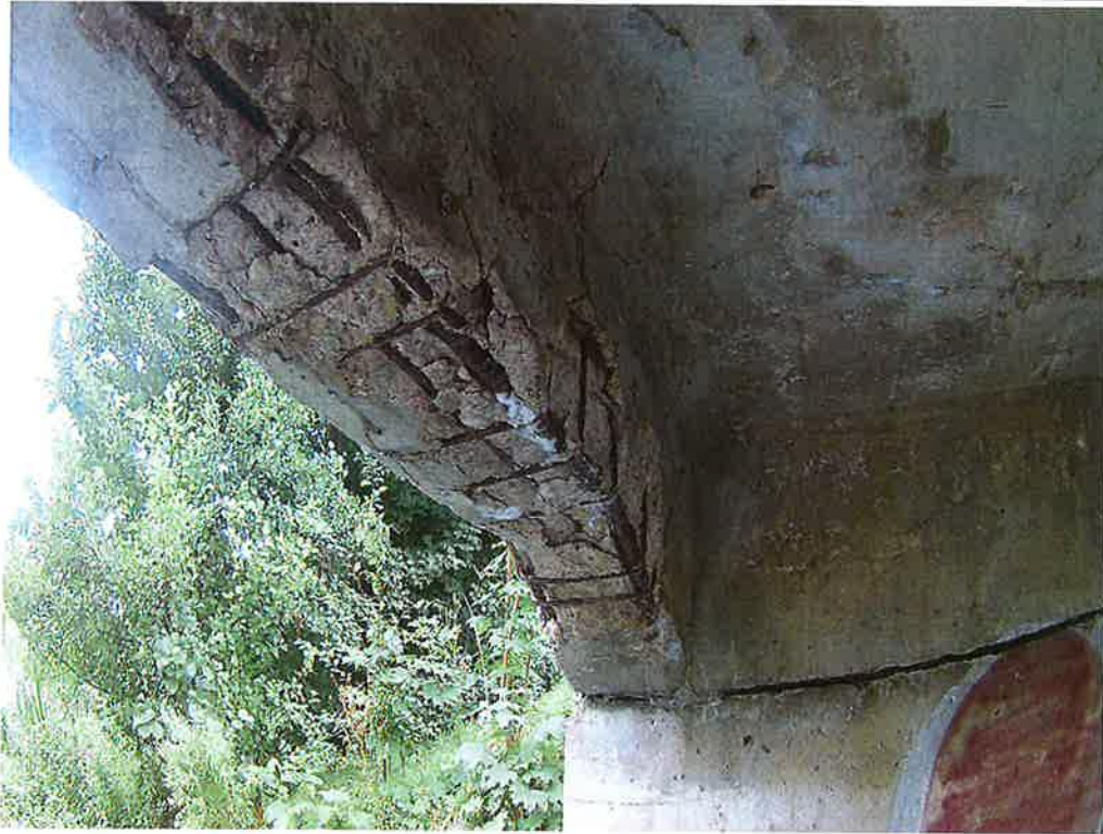
Fot. 3. Znaczne ubytki betonu w jednym z dźwigarów
