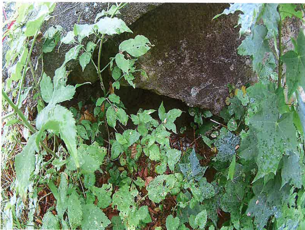
Fot. 2. Osunięcie nasypu skarpy ściany przyczółka
