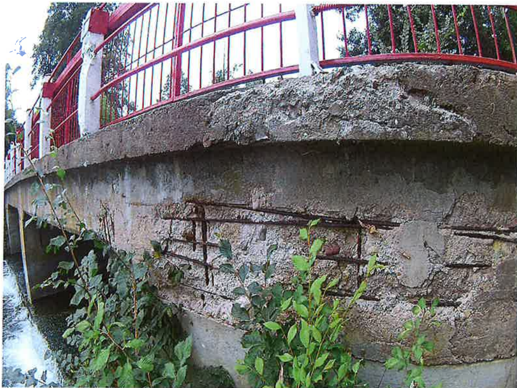
Fot. 4. Ubytki otuliny zbrojeniowej w konstrukcji ściany przyczółka
