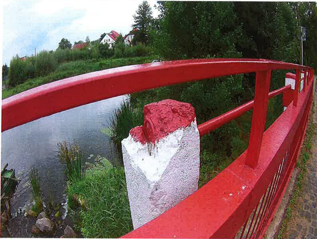
Fot. 1. Ubytki betonowego fragmentu bariery dla pieszych
