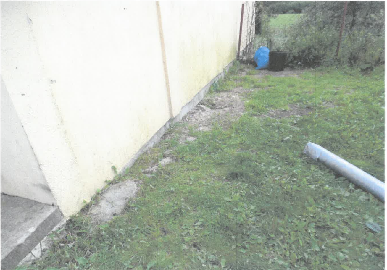
Fot.6 Na zewnątrz budynku, od strony szczytu, wskazane jest wyrównanie terenu i wykonanie opaski odwadniającej, by wody opadowe były odprowadzane od budynku.
