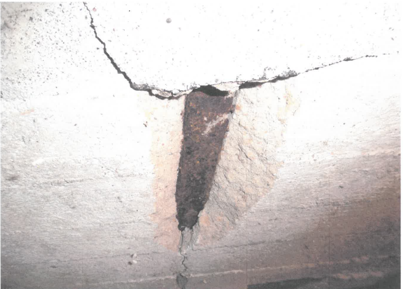
Fot. 2. Widoczne pęknięcie betonowej otuliny zbrojenia stropu.
