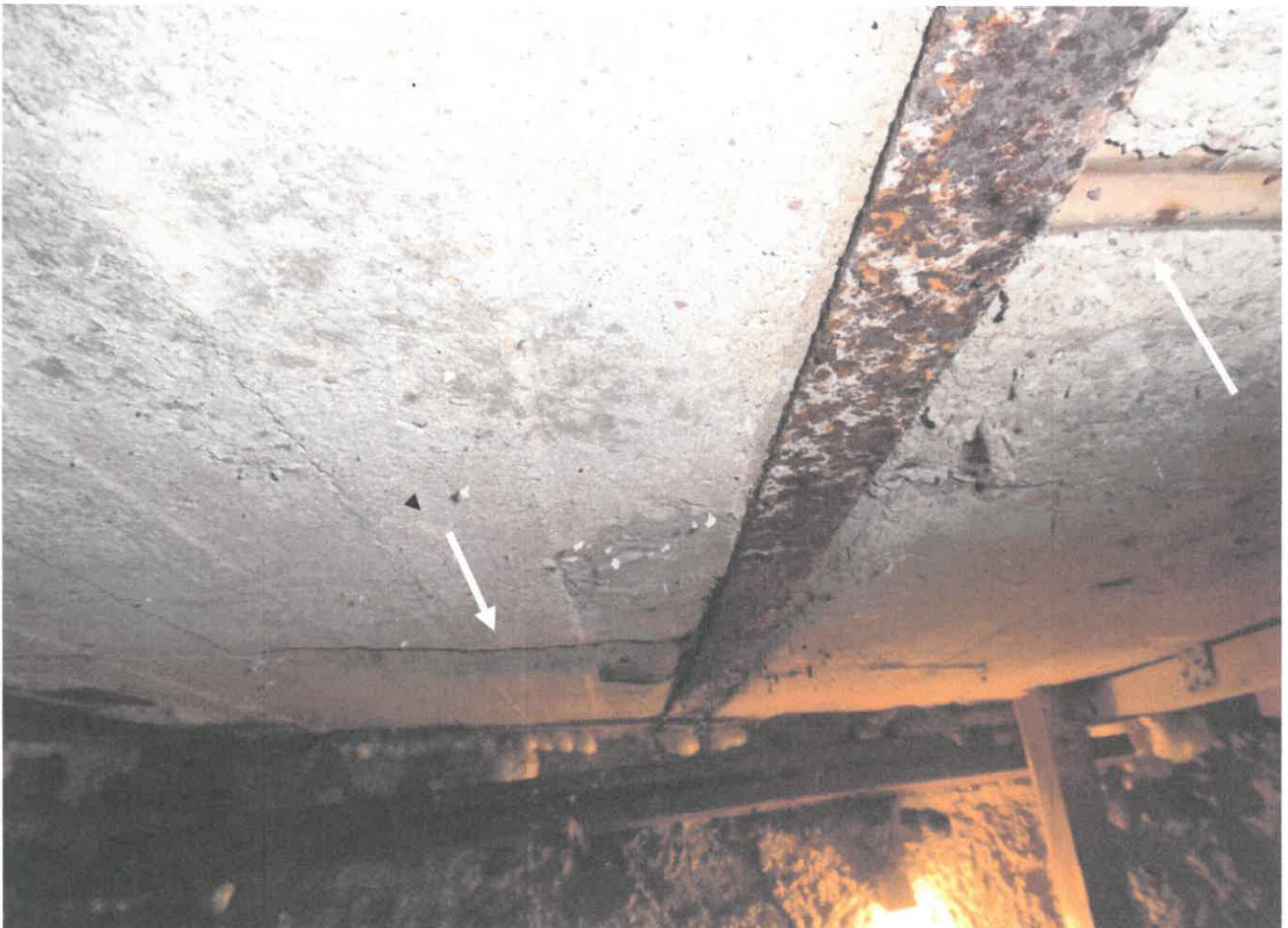
Fot.3 i 4 Widoczne zardzewiałe szyny, na których oparty jest żelbetowy strop, oraz poprzeczne pęknięcie otuliny betonowej wzdłuż metalowego zardzewiałego płaskownika.
