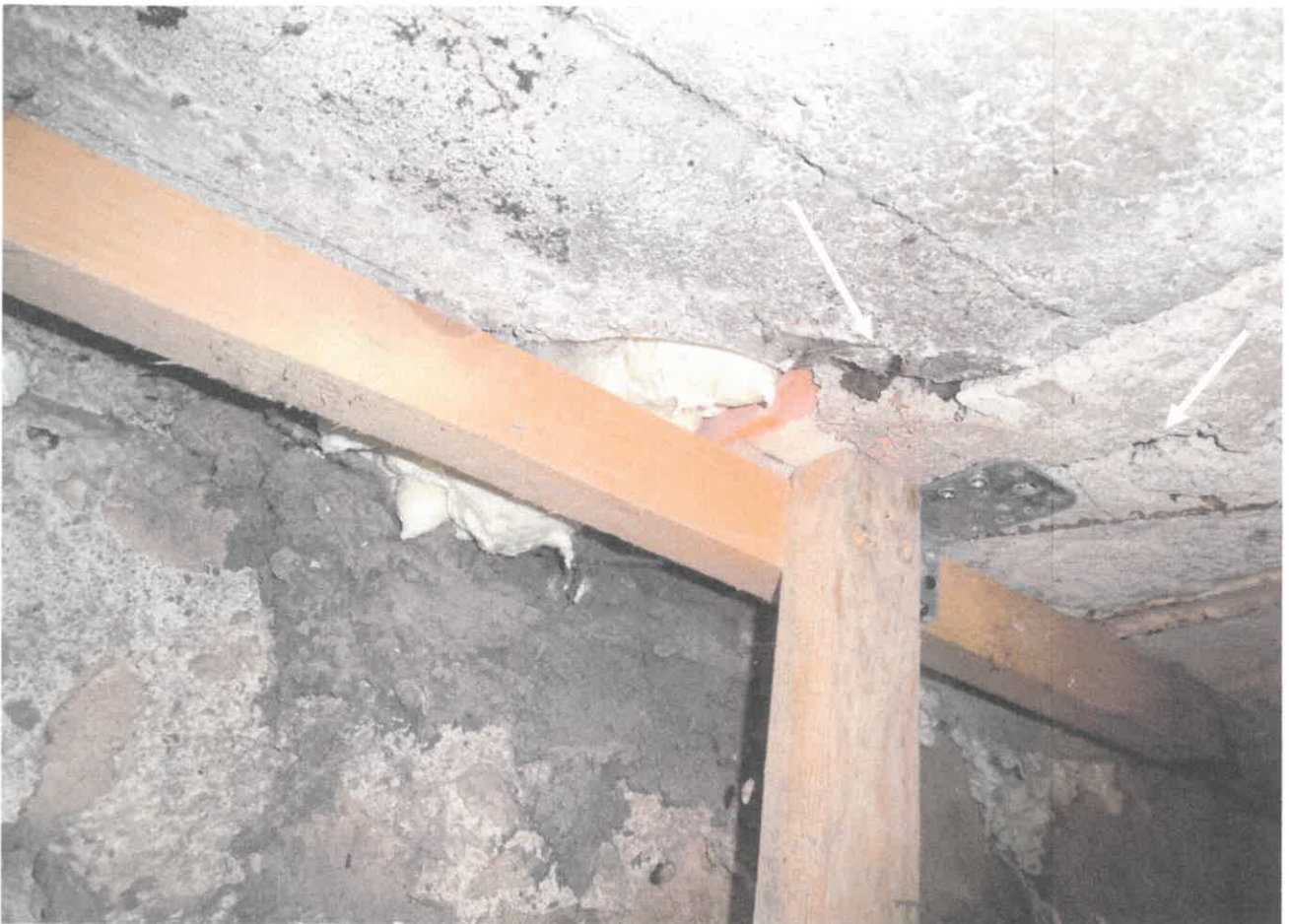
Fot.5 Widoczne inne pęknięcia na stropie w piwnicy, widoczne zardzewiałe elementy metalowe stropu.
