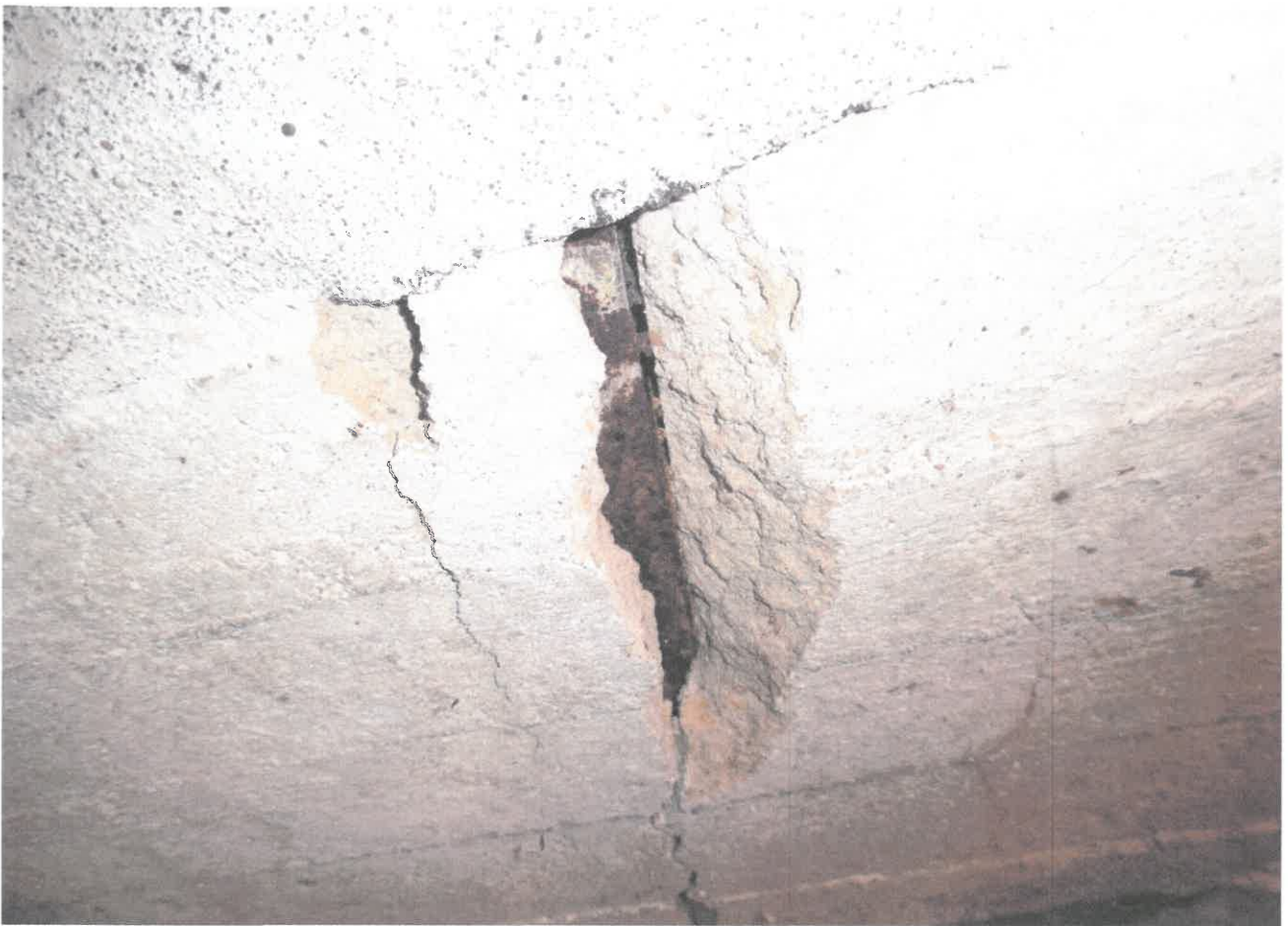
Fot. 1. Widoczne miejsce odspajania się betonu od zardzewiałych płaskowników w stropie.
