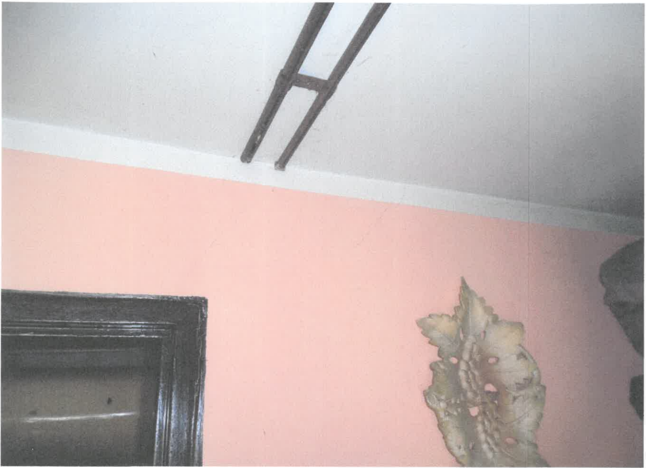
Fot.7 Na zdjęciu widoczne rysy na ścianie nad otworem drzwiowym między korytarzem a łazienką spowodowane ugięciem się stropu nad piwnicą. Jest to ugięcie charakterystyczne dla stropów gęsto żebrowych. W tym miejscu należy zbić tynk i nałożyć siatkę metalową, ponownie otynkować.
