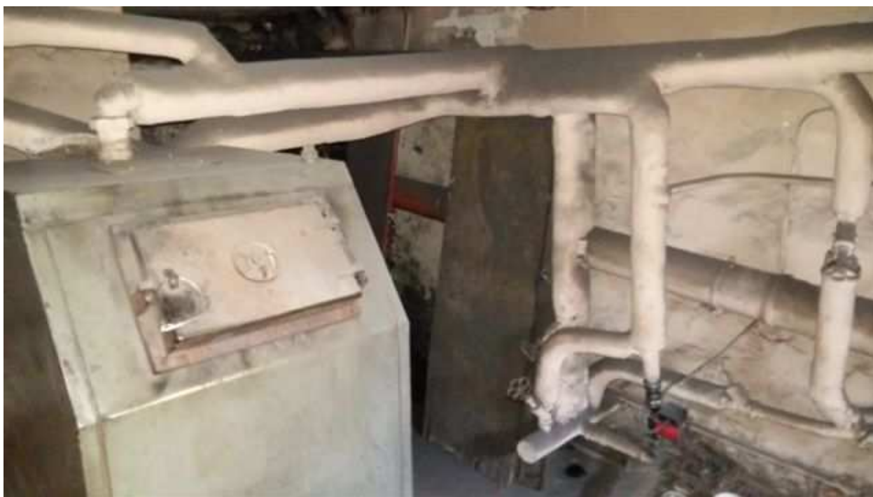
Widok kotłowni w piwnicy budynku
