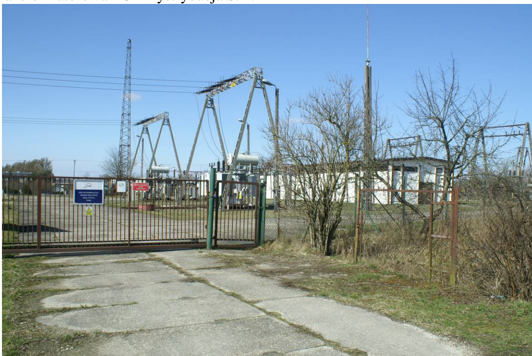
Fot.9. Stacja transformatorowa PGE na dz. nr ewid. 15
